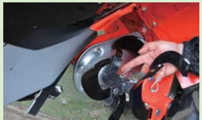
ロータリーのこの部分からオイルが漏れていないかチェック
